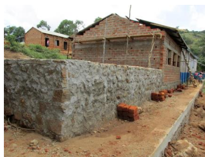
↑基礎から見たところ。トラックが入れない山間で、セメントや鉄筋も手作業で搬入。
